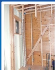
アルミダクト
